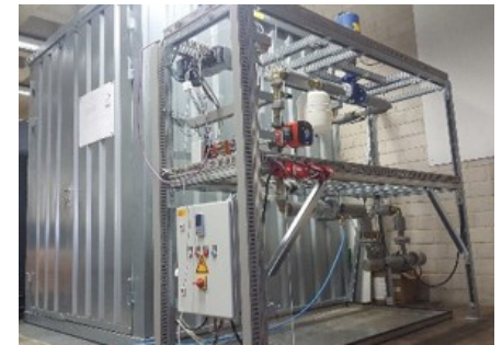
Abbildung 1: Heizungspumpenprüfstand der Hochschule Kaiserslautern
